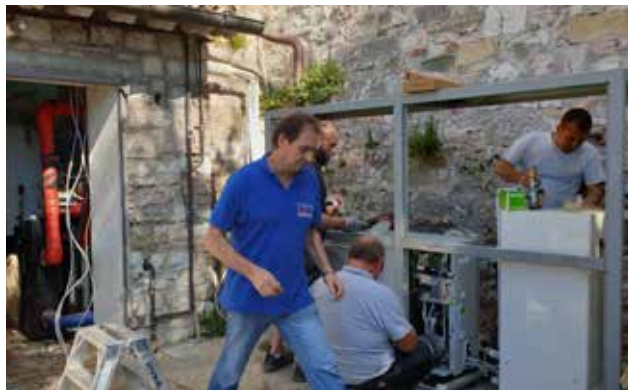
Lavori nel reparto delle caldaie
